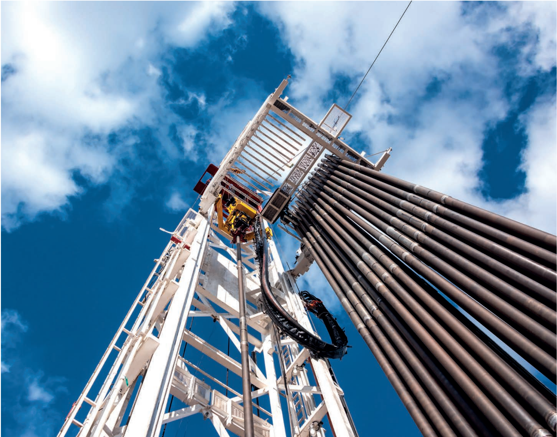
El pozo Loma Campana LLL 1524 h batió el récord de profundidad de la Cca. Neuquina en 2017. Fue perforado en solo 37 días, recorre 3300 metros en vertical y 3200 en horizontal.
